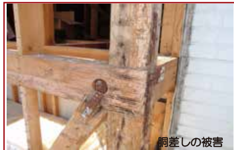
洞差しの被害
